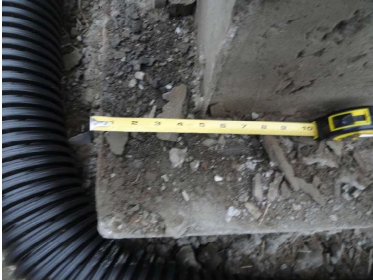
Mesure de la semelle de fondation, coin sud-est
