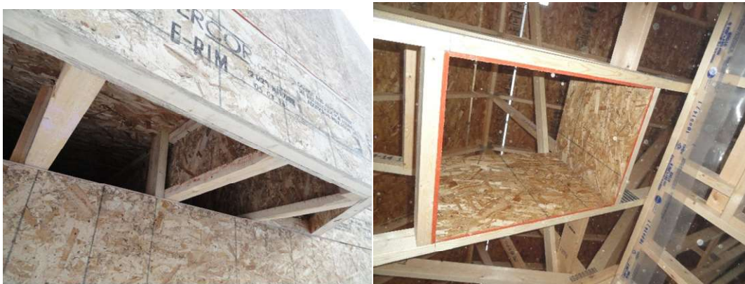
Espaces de ventilation
