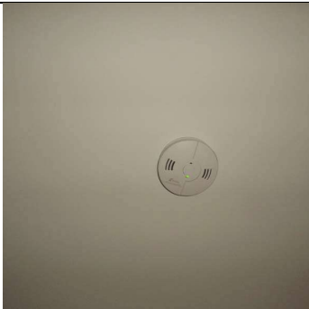
2014-12-12 Décteur MC et de fumée au sous-sol DSC03797 site 809 Décteur MC et de fumée au sous-sol.JPG
